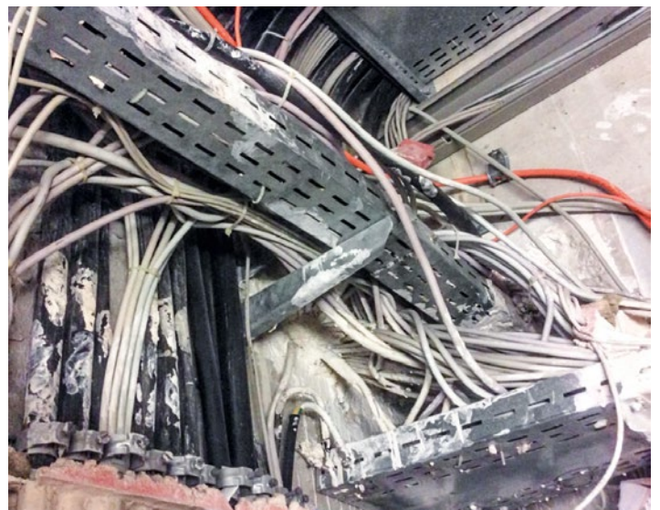
Nicht fachgerechte Kabelbeschichtung und Kabelbündelung
